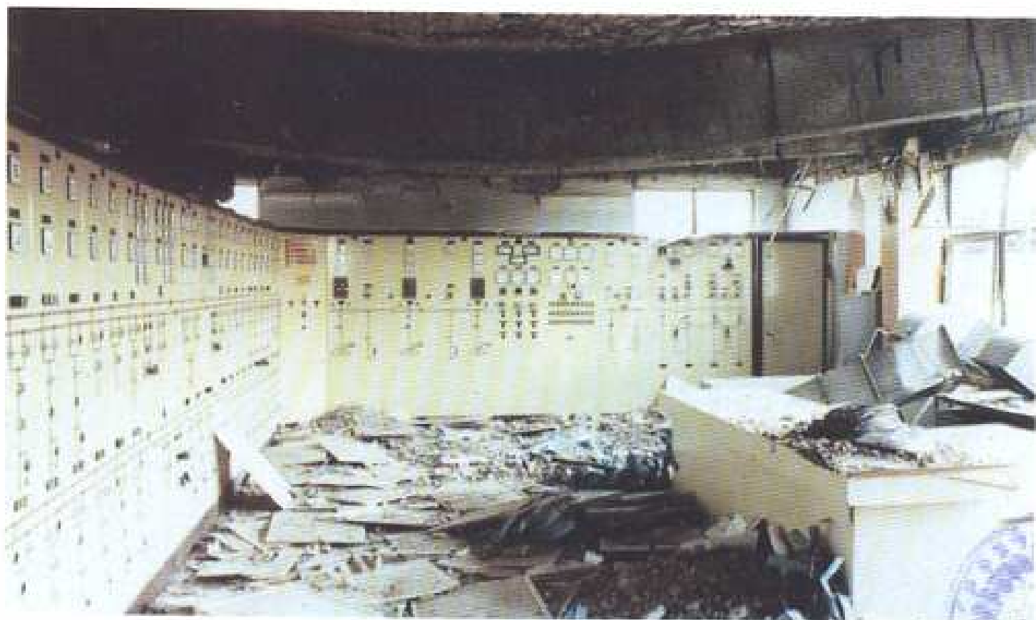
Слика 21 Изглед оштећене командне собе трафо-станице III у РТБ – Бор, 15. 05. 1999. године
