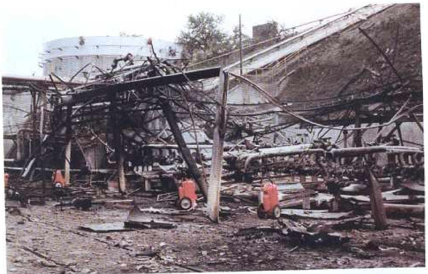
Слика 8 Уништена пумпна станица бр. 1. у „Југопетролу“ Београд – инсталација Прахово – Бор, дан 07. 05. 1999. године (први напад)
