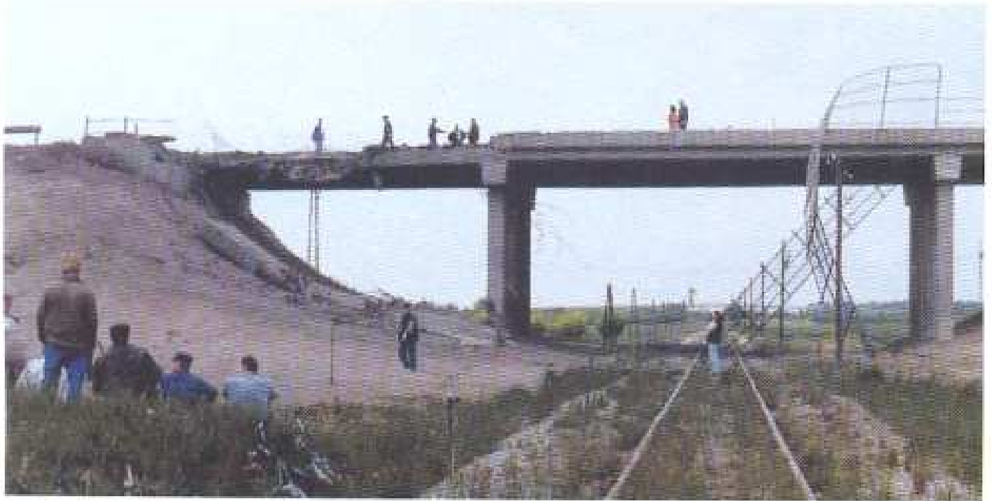
Слика 55 Оштећени надвожњак на магистралном путу Е-75 код Хоргоша и оштећење пруге Суботица – Хоргош – Сегедин, дана 11. 05. 1999. године
