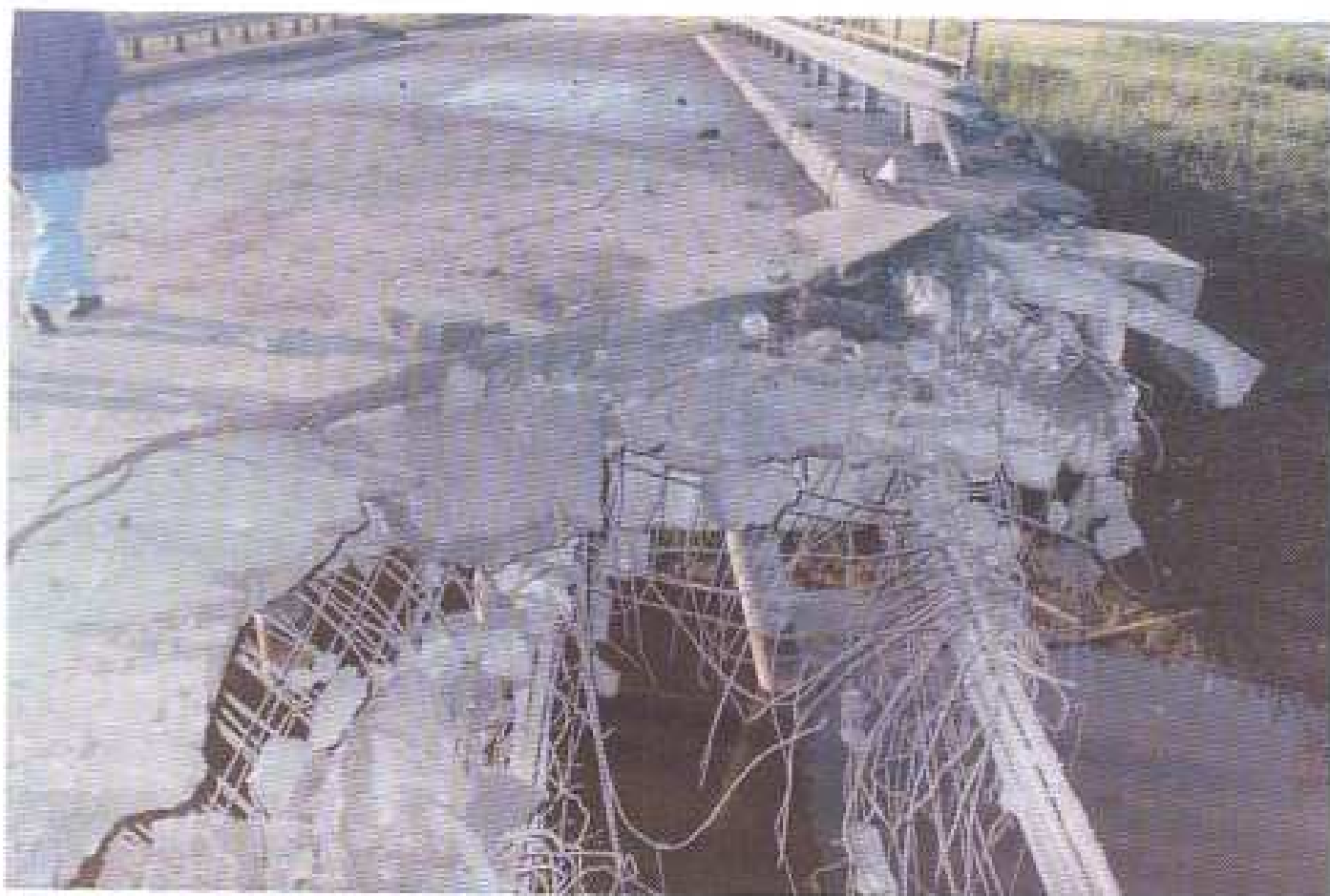
Слика 74 Ближи изглед оштећења на мосту преко Старог Бегеја
