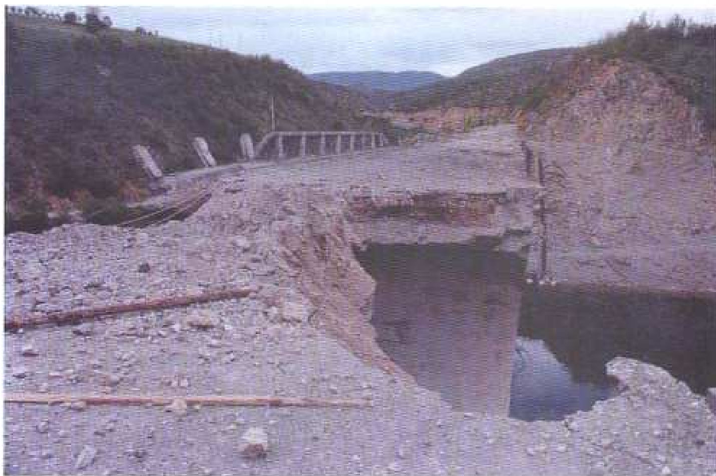
Слика 58 Ближи изглед оштећења на мосту у Кокином Броду, дана 11. 05. 1999. године
