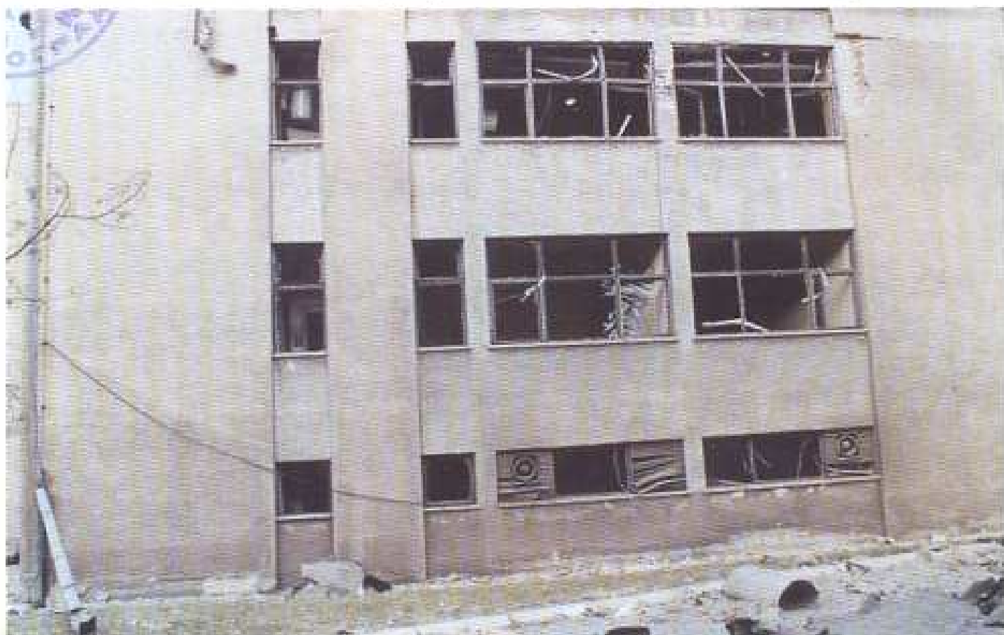
Слика 18 Шири изглед оштећења на згради трафо-станице бр. 3 у кругу РТБ-Бор, дана 15. 05. 1999. године
