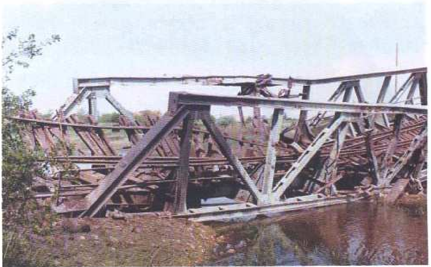
Слика 37 Срушени железнички мост на прузи Београд – Букурешт преко реке Моравице у Ватину – Вршац, дана 06. 05. 1999. године
