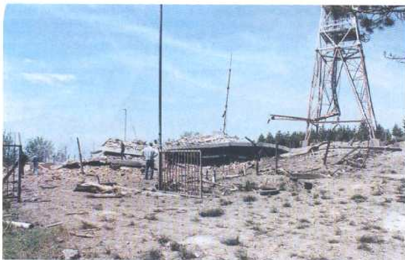
Слика 16 Ближи изглед срушене зграде и оштећеног антенског стуба на Церу, 19. 05. 1999. године
