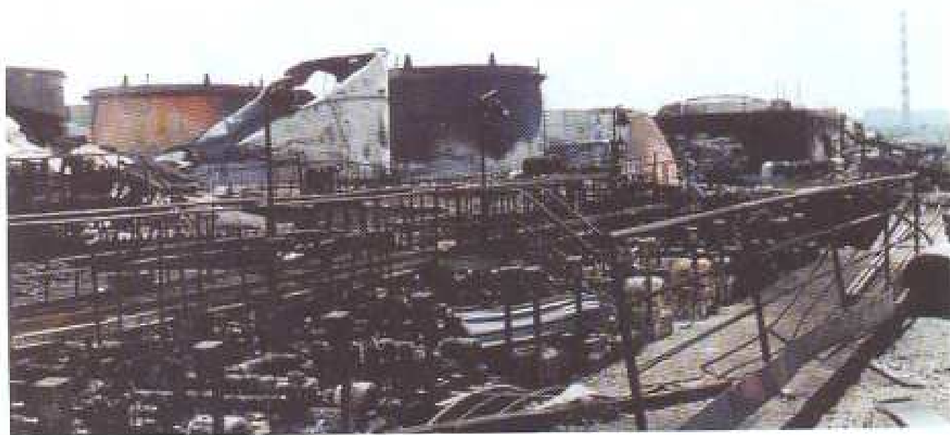
Слика 35 Уништена цевна постројења и резервоари у Рафинерији нафте Нови Сад, дана 09. 06. 1999. године
