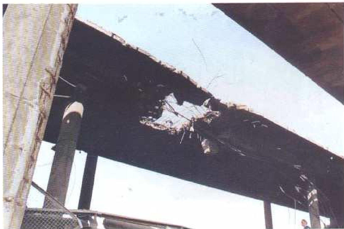
Слика 48 Место поготка пројектила на надвожњаку аутопута
