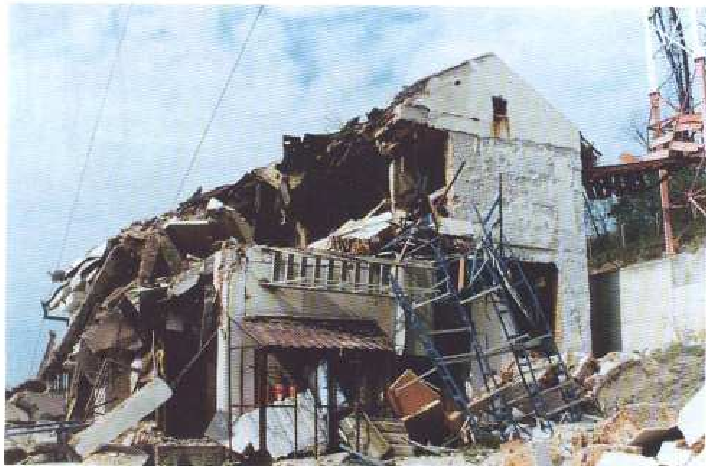
Слика 10 Срушена зграда релетитора РТС-а на Вршачком брегу у Вршцу, дана 11. 05. 1999. године
