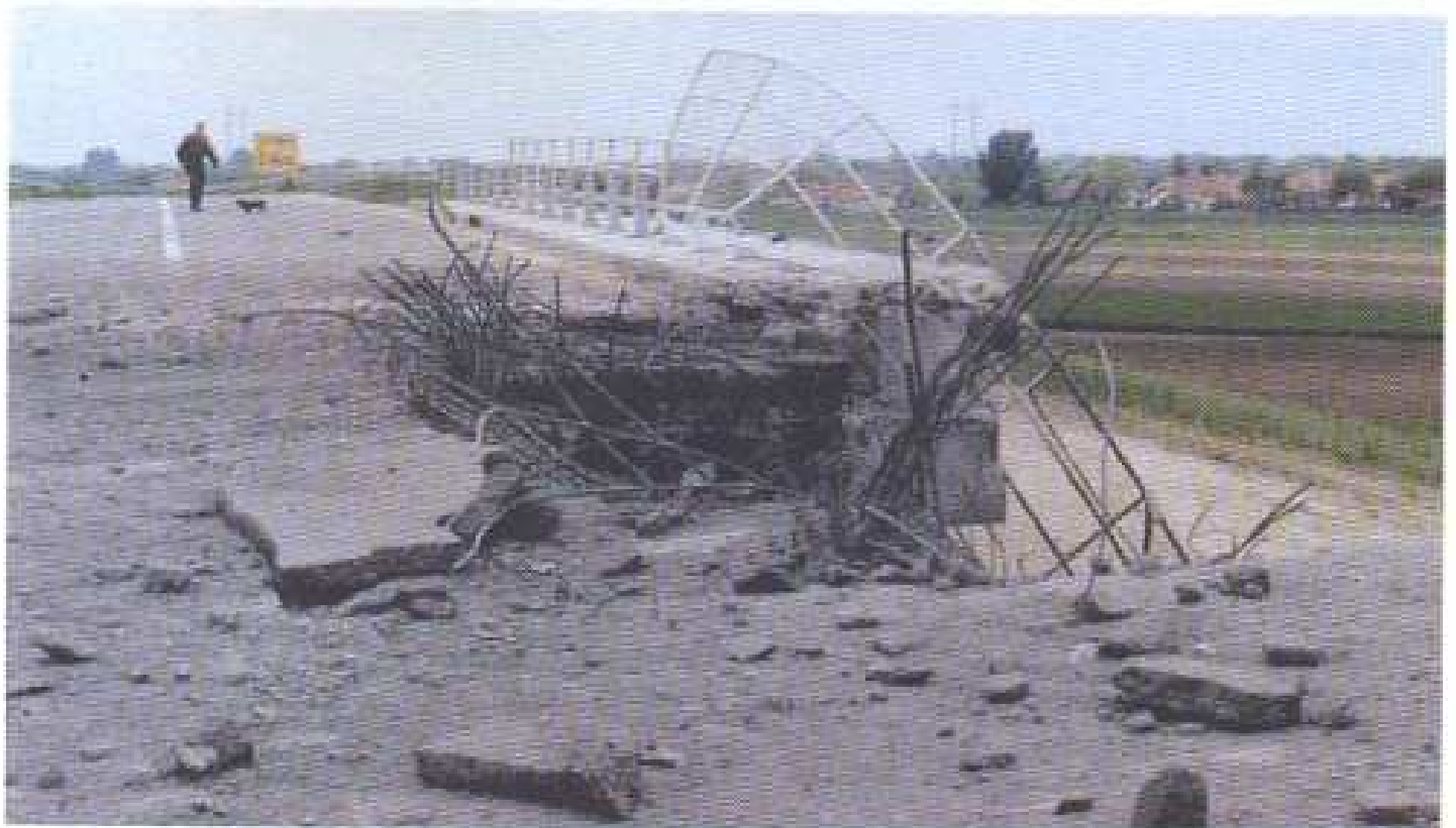
Слика 56 Ближи изглед оштећења на надвожњаку код Хоргоша, дана 11. 05. 1999. године
