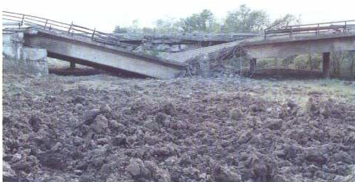
Слика 75 Срушени мост преко реке Јасенице на аутопуту Београд – Ниш у Великој Плани, дана 21. 05. 1999. године (други напад)
