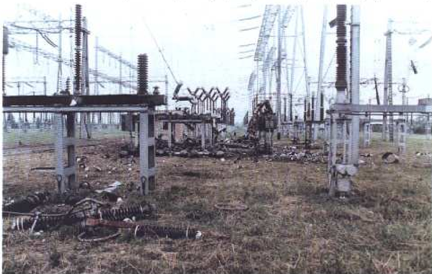
Слика 44 Оштећена разводна високонапонска постројења на термоелектрани А у Уровцима – Обреновац, дана 23. 05. 1999. године
