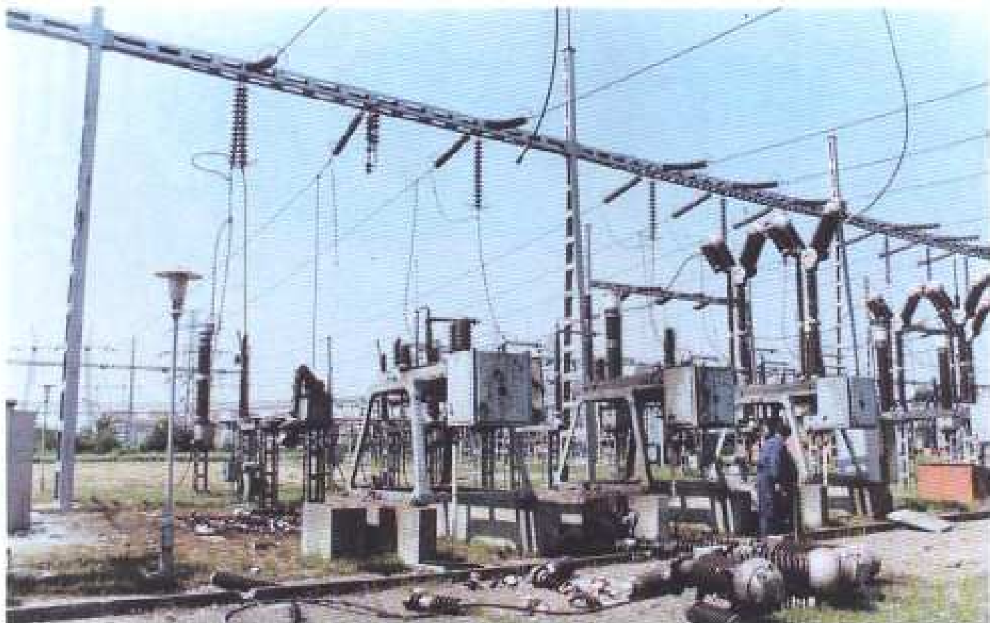
Слика 51 Оштећења на електропостројењима од 220 kV Трафо-станице „Београд 5” на Бежанијској коси
