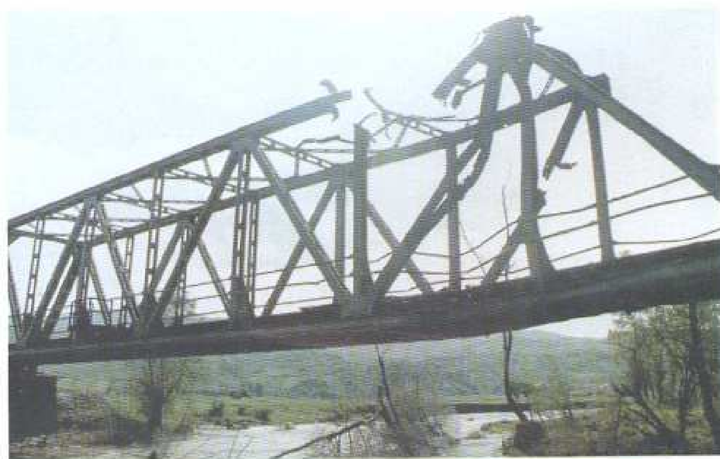
Слика 11 Оштећени железнички мост на реци Топлици у селу Подина, Житорађа – Прокупље, дана 29. 04. 1999. године (први напад)
