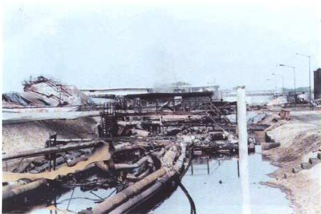
Слика 36 Ближи изглед уништених постројења у Рафинерији нафте, Нови Сад
