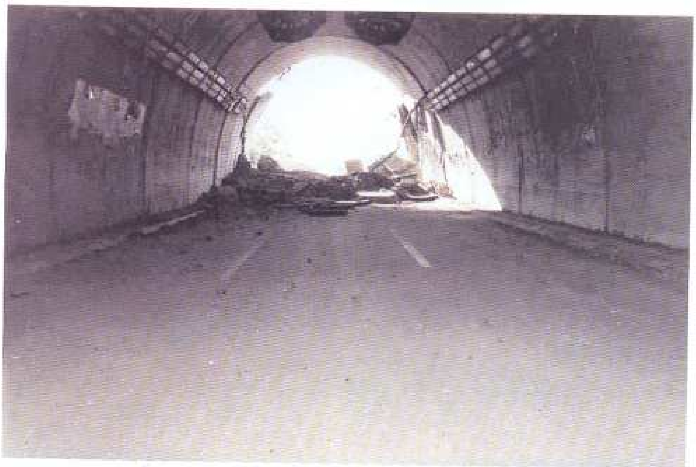
Слика 107 Изглед оштећења гледано из тунела, дана 30. 05. 1999. године
