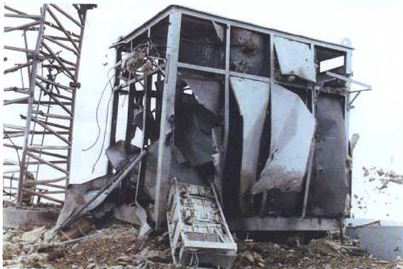
Слика 30 Уништени контејнер са уређајима мобилне телефоније, власништво „Мобтела” из Београда на месту зв. „Гобеља” на Копаонику, дана 03. 06. 1999. године
