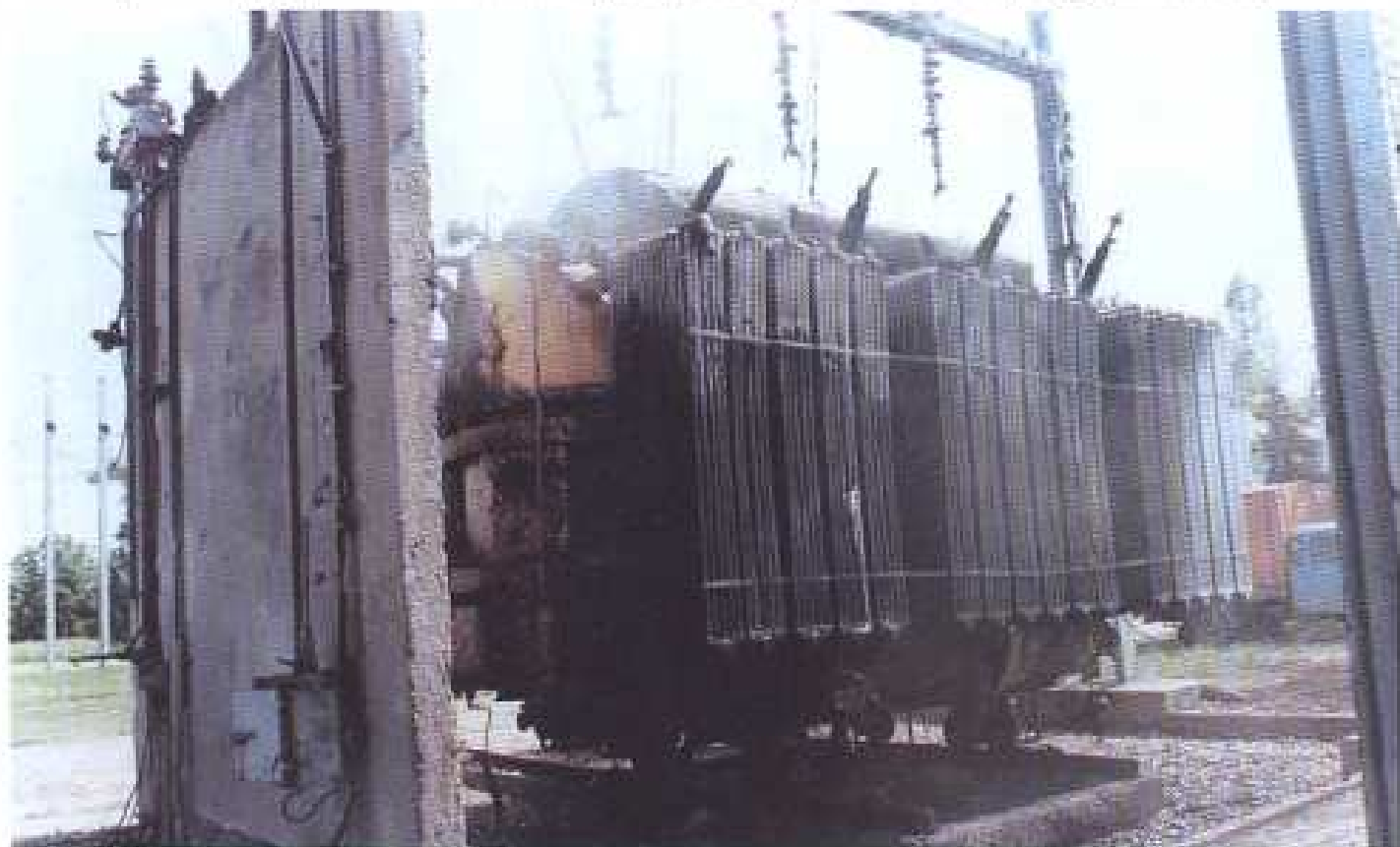
Слика 50 Оштећење постројења Електропривреде Србије – трансформатори Т-4, трафо-станице „Београд 5” у насељу Бежанијска коса у Новом Београду, дана 27. 05. 1999. године
