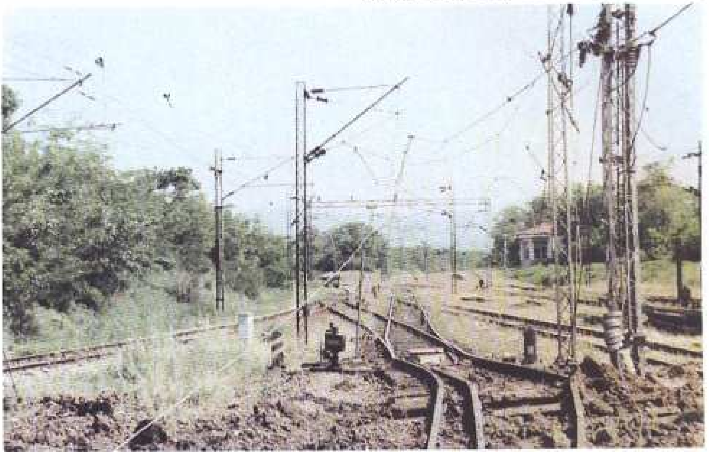
Слика 87 Оштећење колосека и електричног вода у Ранжирној станици у селу Поповац – Ниш, 27. 05. 1999. године
