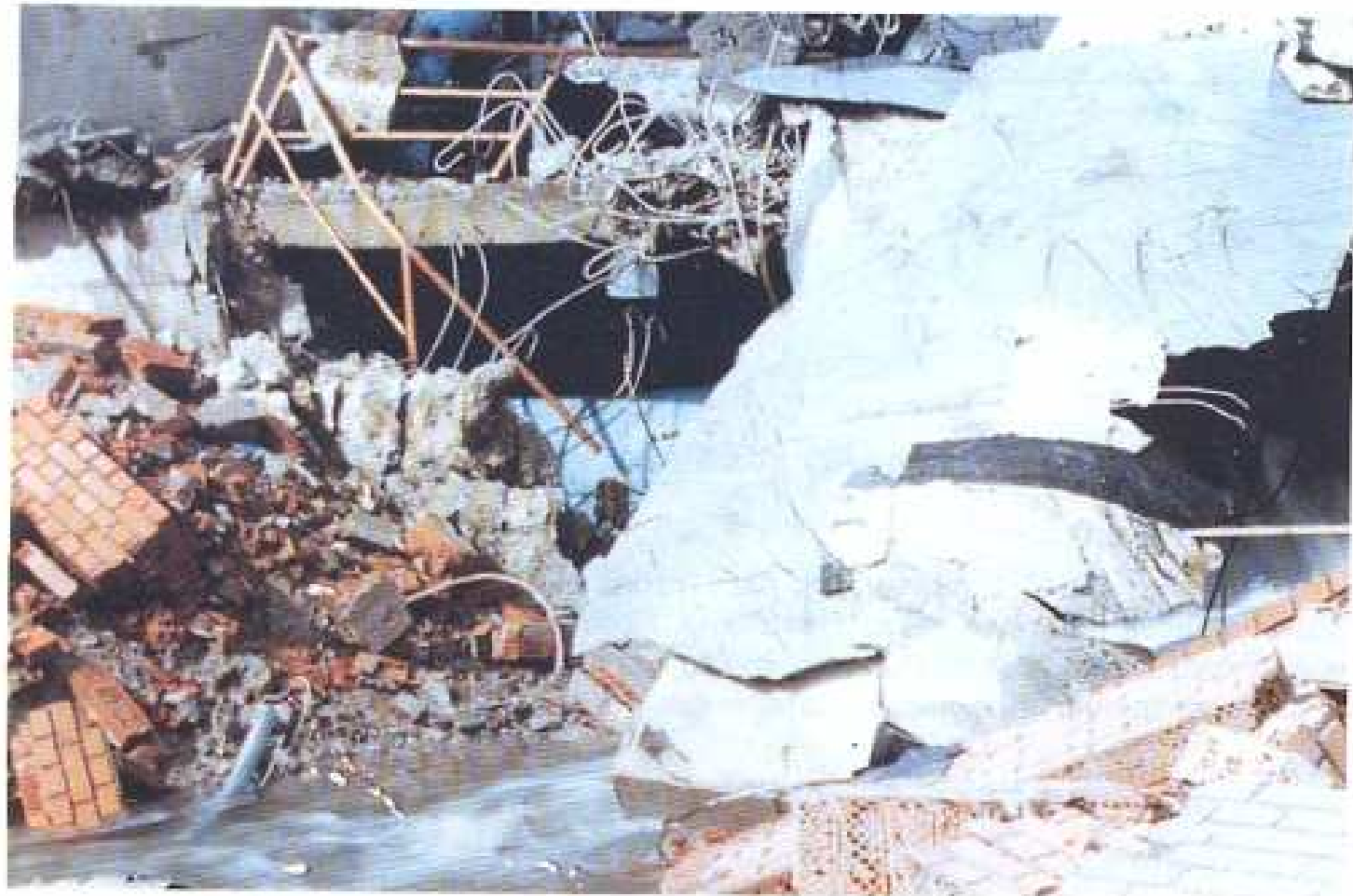
Слика 2 Ближи изглед уништене цркне станице „Бадовац”
