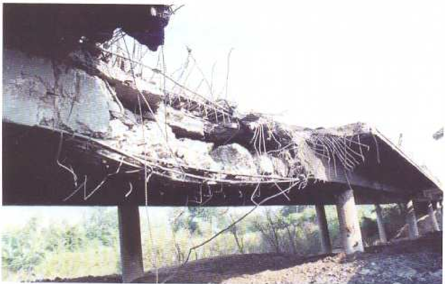
Слика 78 Ближи изглед оштећења леве стране моста преко Јасенице, десна страна је срушена у ранијим нападима
