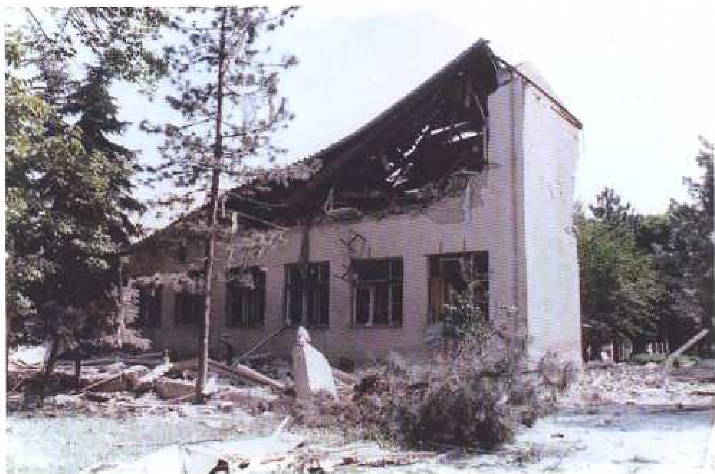
Слика 16 Срушена управна зграда МК „Прва искра” у Баричу, дана 10. 05. 1999. године
