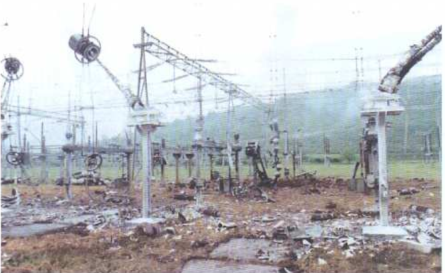
Слика 47 Изглед оштећења на електропостројењима, од 400 kV ЈП „Електростокa" – Ниш 2 у Нишу, Булевар Вељка Влаховића бб, дана 23. 05. 1999. године
