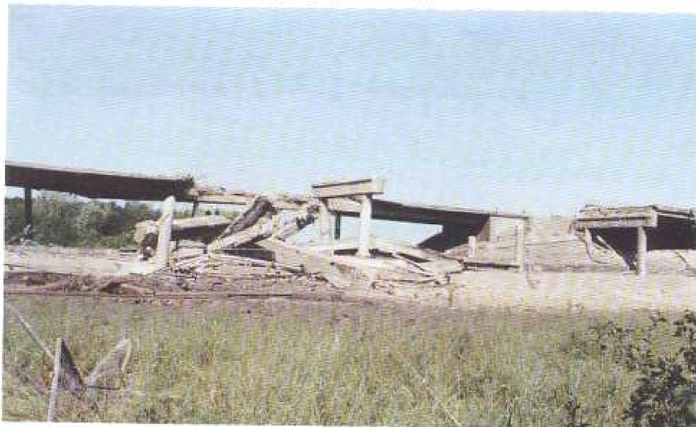
Слика 110 Срушени надвожњак на аутопуту Београд – Ниш у атару села Велико Орашје, који је пао на пругу Београд – Велика Плана, дана 02. 06. 1999. године у Великој Плани (трећи напад)
