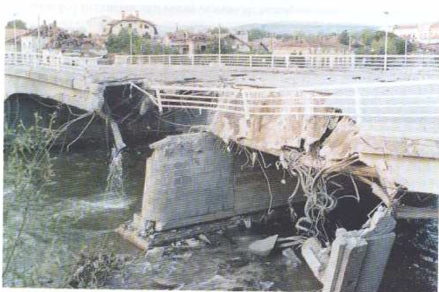
Слика 42 Ближи изглед порушеног моста на Нишави
