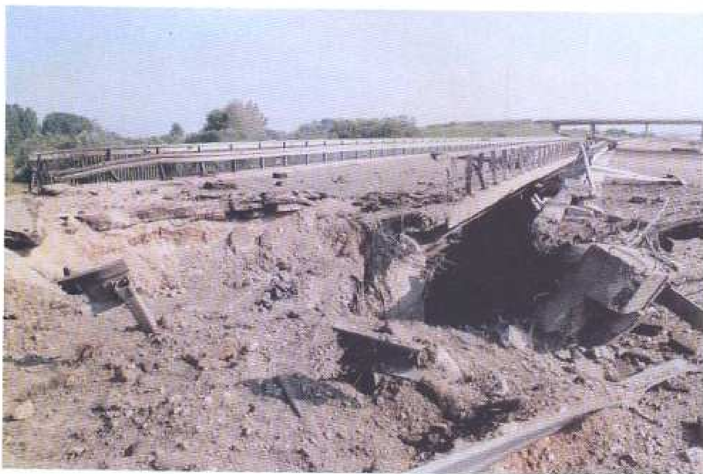
Слика 90 Ближи изглед оштећења на мосту преко Нишаве, дана 28. 05. 1999. године
