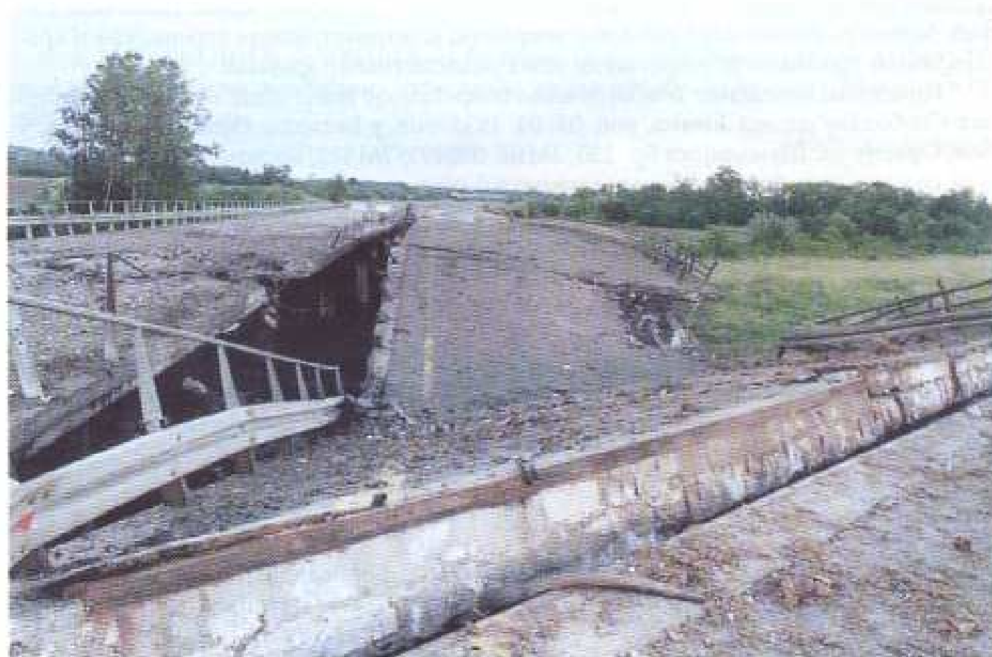
Слика 76 Ближи изглед срушеног моста преко Јасенице
