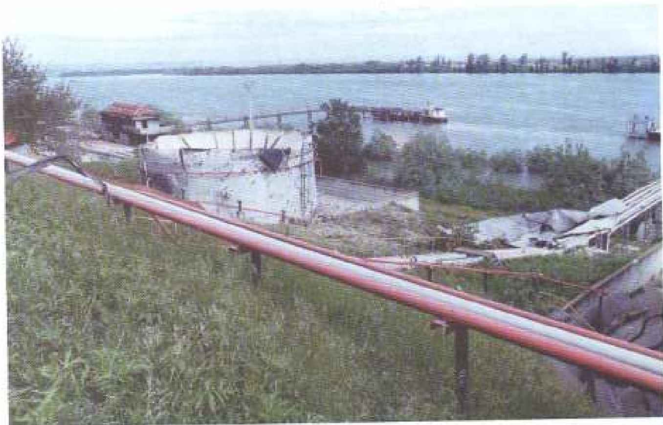
Слика 18 Уништени резервоари у „Југопетролу“ Београд – Инсталација Прахово – Бор, дана 17. 05. 1999. године (други напад)
