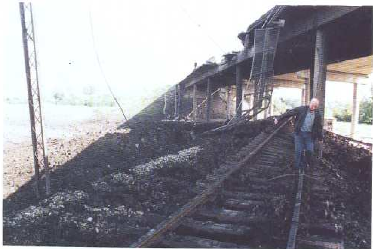
Слика 49 Оштећење железничке пруге Београд – Велика Плана испод надвожњака аутопута
