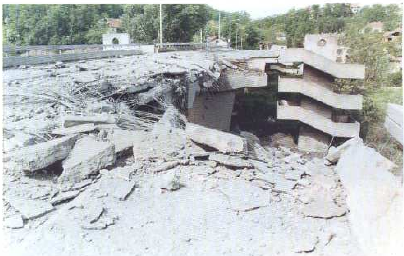
Слика 69 Оштећења на средини моста преко Јужне Мораве у Владичином Хану
