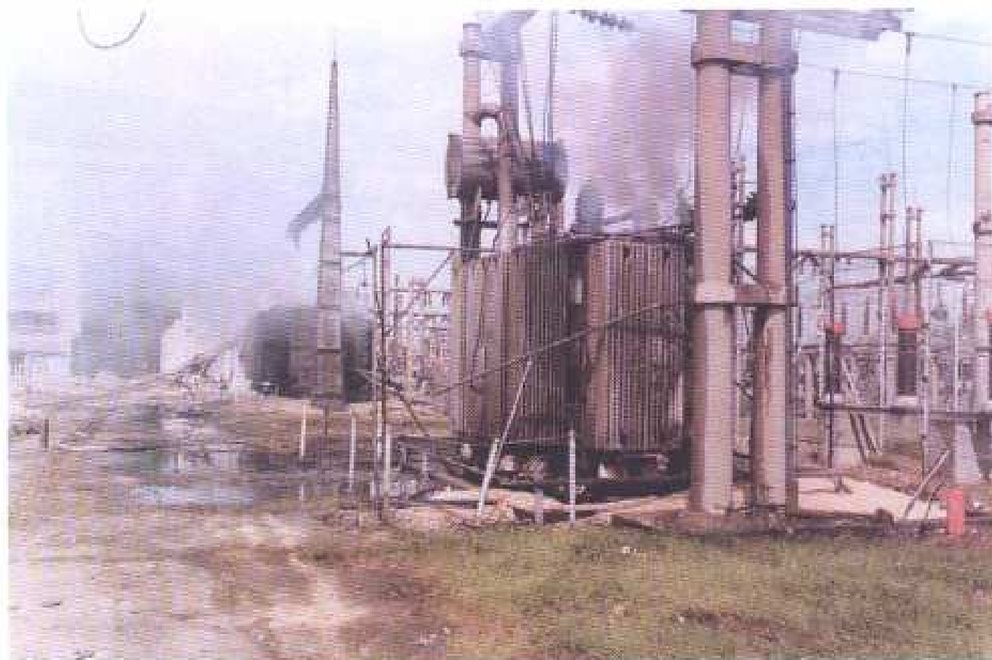
Слика 42 Оштећени блоковски трансформатори ТЕ „Велики Црљени”
