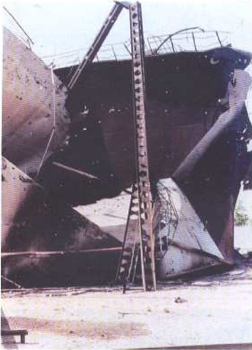
Слика 22 Разорени резервоар бр. 3. у централном складишту НИС „Нафтагас промет“ у Сомбору у ул. Ф. Кљајића бб, дана 20. 05. 1999. године
