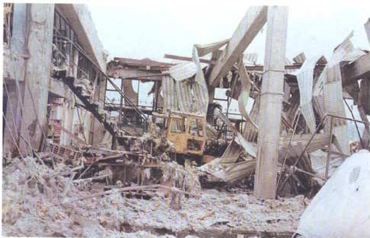
Слика 25 Ближи изглед оштећења објекта „Механизација” у ГП „Биначке Мораве” у Гњилану, дана 19. 05. 1999. године
