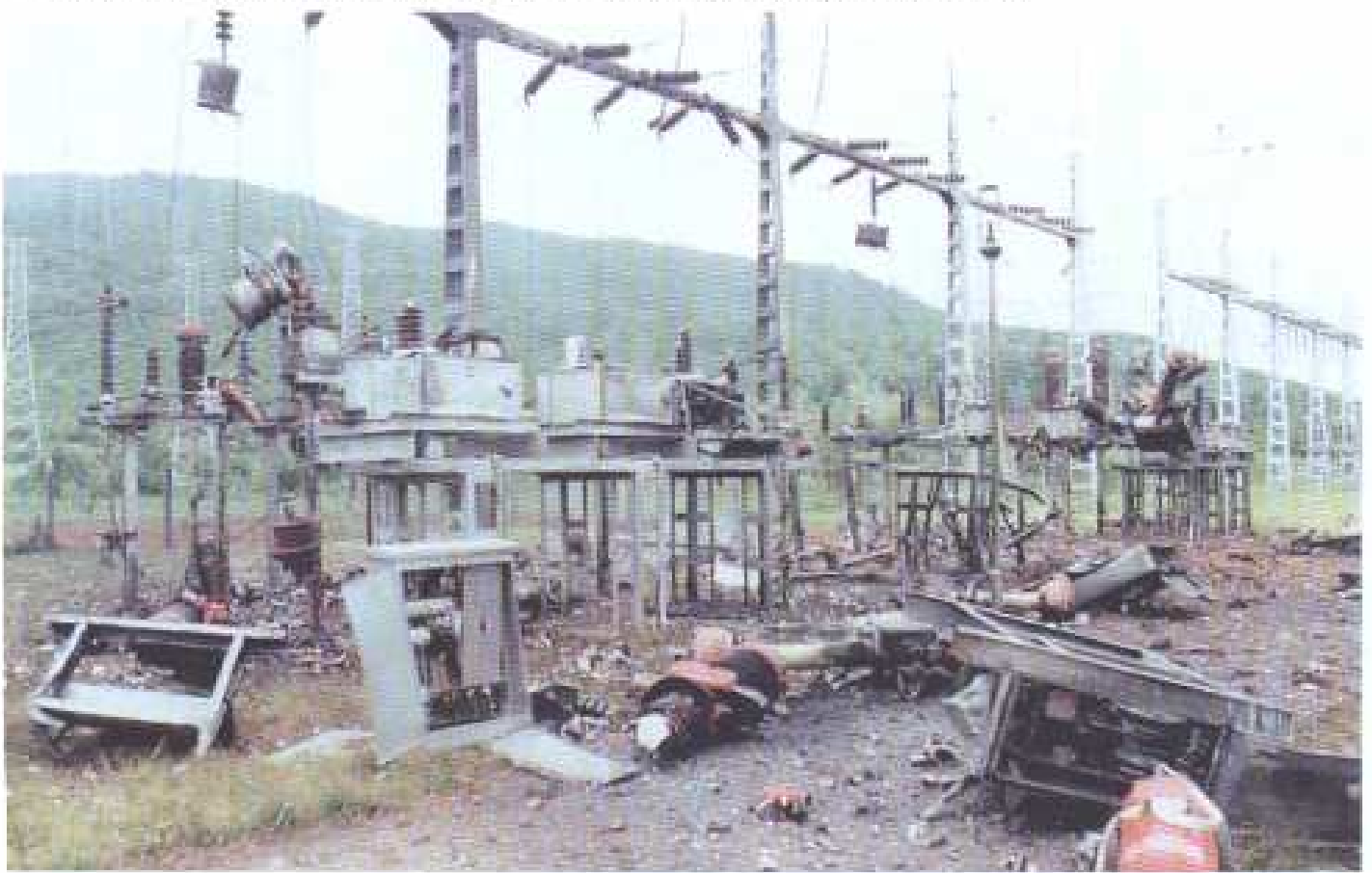
Слика 46 Изглед оштећења електропостројења, од 110 kV ЈП „Електростокa" – Ниш 2 у Нишу, Булевар Вељка Влаховића бб, дана 23. 05. 1999. године
