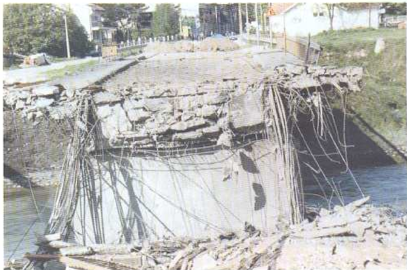
Слика 26 Ближи изглед срушеног моста у селу Дедина
