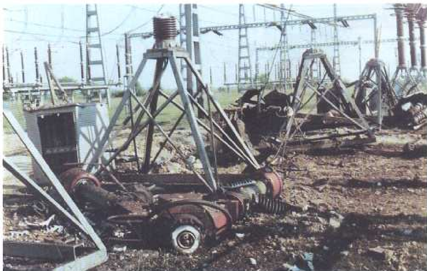
Слика 49 Изглед разореног постројења Трафо-станице „Нови Сад 3“ – поље снаге 380 kV, дана 24. 05. 1999. године
