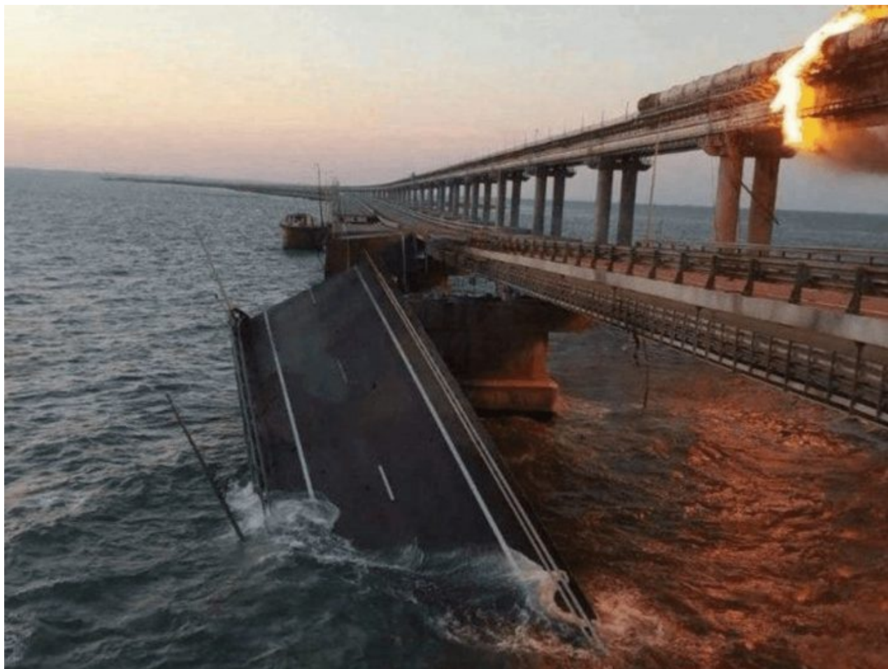
Odhozená vozovka Krymského mostu po explozi
