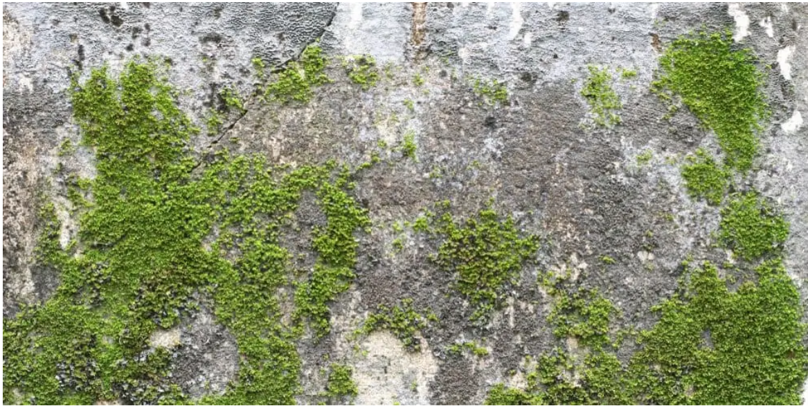
Mech na betonu
