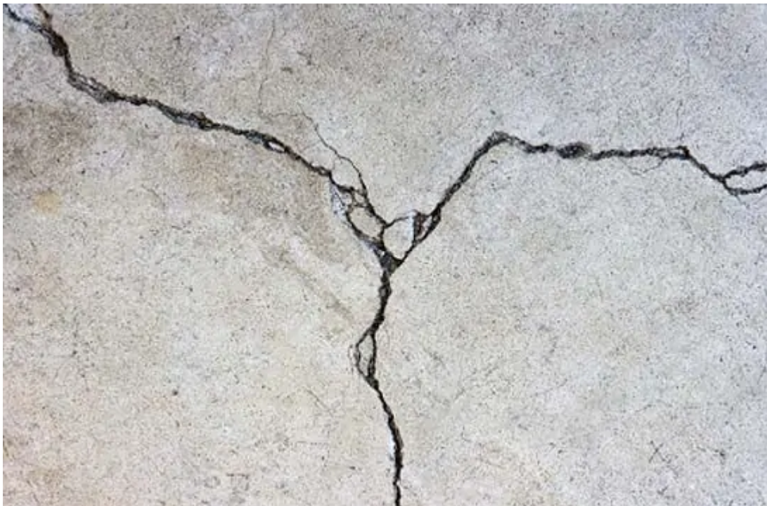
Praskání betonu v důsledku smršťování ve vázaném betonovém prvku
