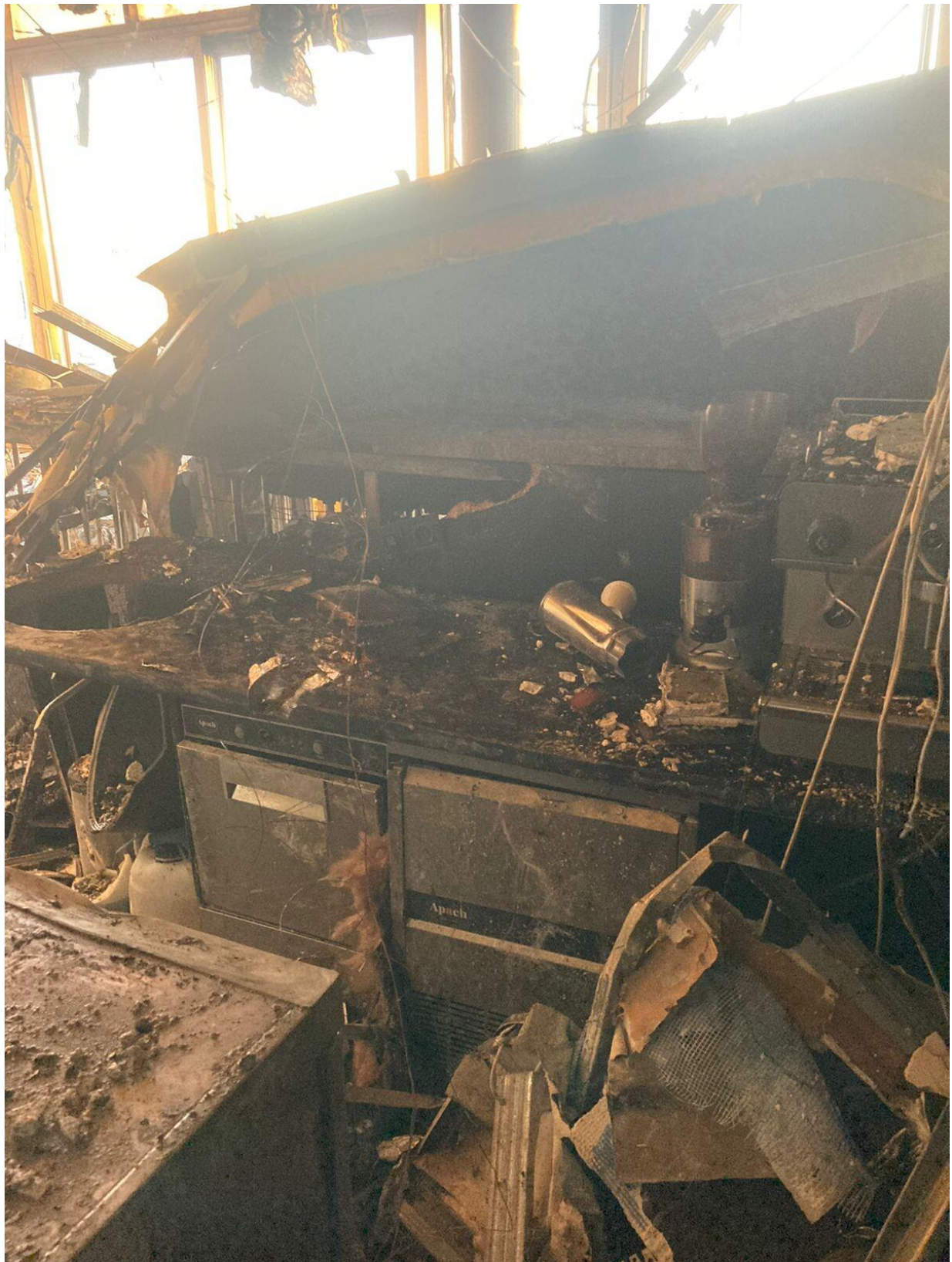
Byt v luxusním kyjevském mrakodrapu po čtvrtěční ranní návštěvě Gosudarových dronů. Ve čtvrtek byl shodou okolností 7. listopad.
